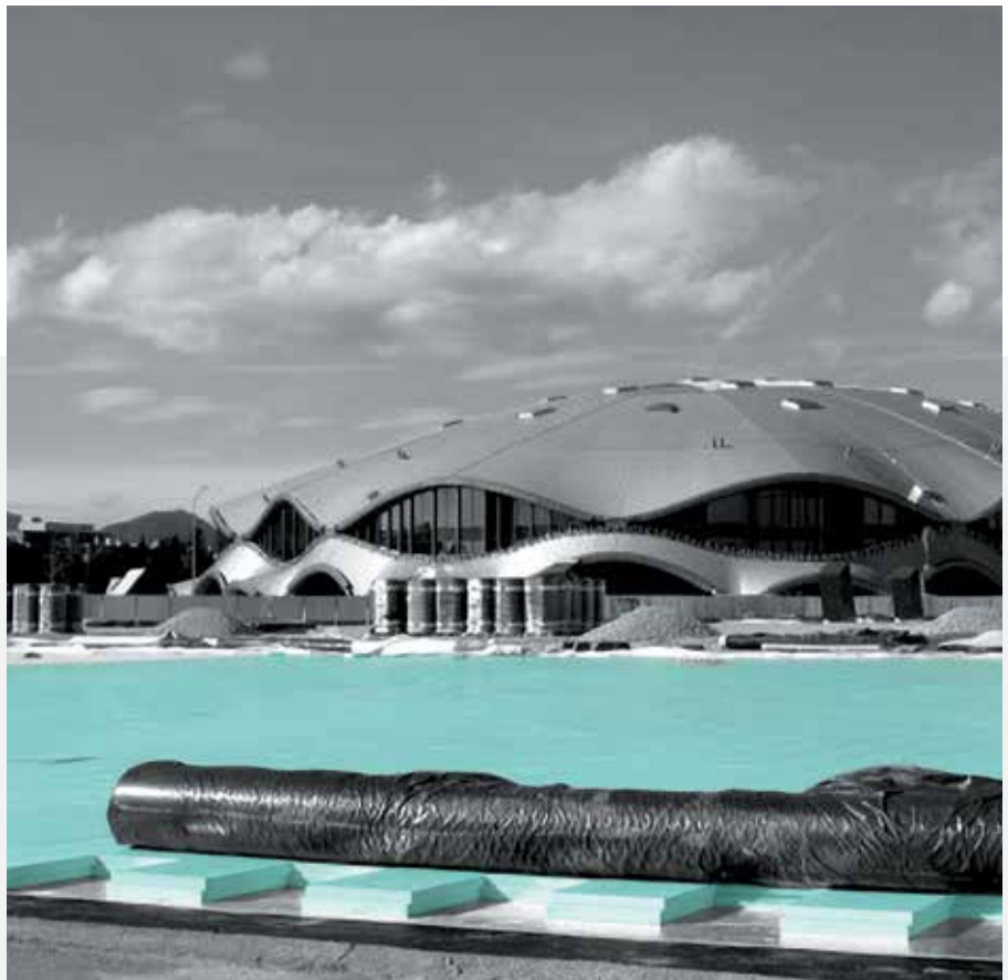
Isolamento termico delle sezioni di un tetto piano con pannelli FIBRANxps di diversi valori di resistenza a compressione
