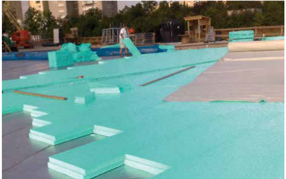
Realizzazione di un tetto piano con pannelli termoisolanti FIBRANxps 300-L; tetto completamente utilizzabile
