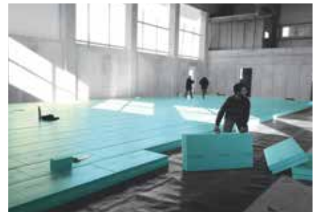
Posa in opera di pannelli termoisolanti FIBRANxps 500-L sotto la fondazione a platea
