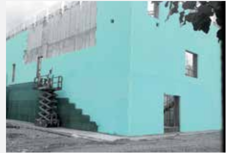
Pannelli FIBRANxps MAESTRO in intercapedine mentre viene eseguito il paramento esterno di facciata con cemento a vista
