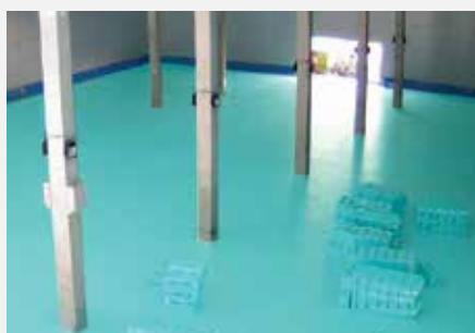
Isolamento termico del pavimento di una cella frigorifera con pannelli FIBRANxps 500-L, 700-L
