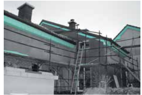
Sporti di gronda realizzati con pannelli FIBRANxps ETICS . Lo spessore dipende dalla luce.
